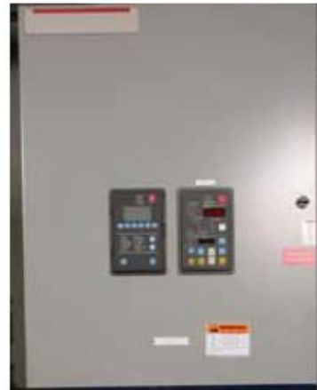
Relevadores multifuncionales, medidores y controles actualizados
