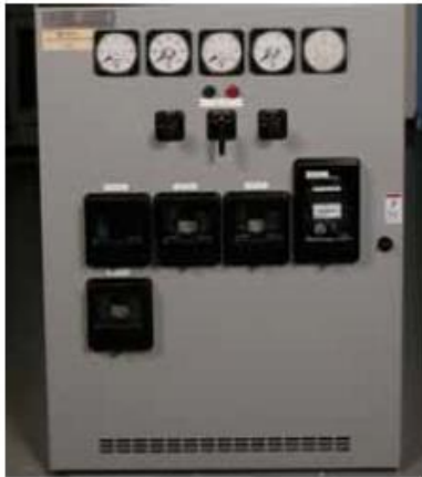
Relevadores, medidores y controles originales
